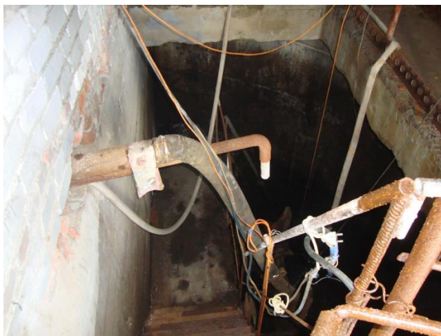
Рисунок 11.2.3 - «Сухое» отделение насосной станции на момент обследования: ниже промежуточной площадки «сухое» отделение затоплено, установлен погружной насос, напорная линия из пожарного рукава
