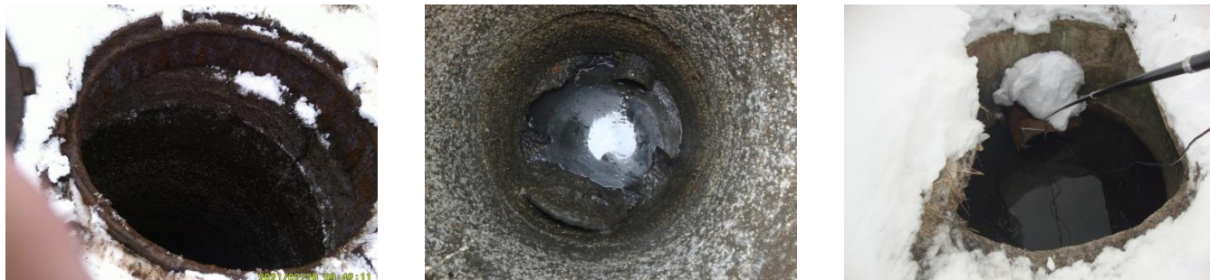
Рисунок 11.2.2 - Канализационные колодцы. Характерное состояние
